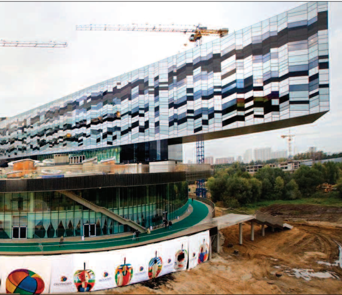
자원에 의존한 경제구조를 지속 가능한 구조로 개편하기 위해 필요한 인재를 양성할 스콜코보 모스크바경영대학원 공사 현장. 100% 민간 자본으로 설립된다.
