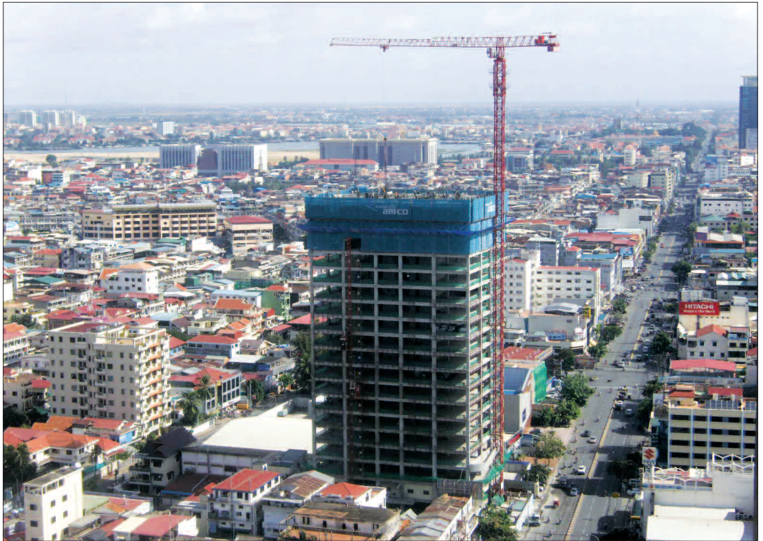
현대엔코건설이 5500만 달러를 투자해 캄보디아 프놈펜에서 공사 중인 '프놈펜 타워'. 2011년 4월 완공 예정이다.
